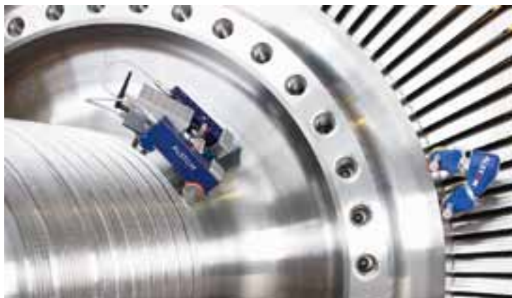
Der Roboter inspiziert die Kupferbahnen eines Generators und überprüft die Isolation. (Bild: ALSTOM Inspection Robotics)
